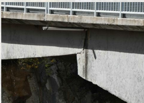
Dilavamento dal sistema di giunti
